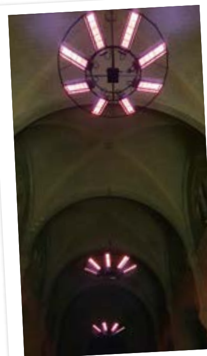
Chauffage de l'Église
